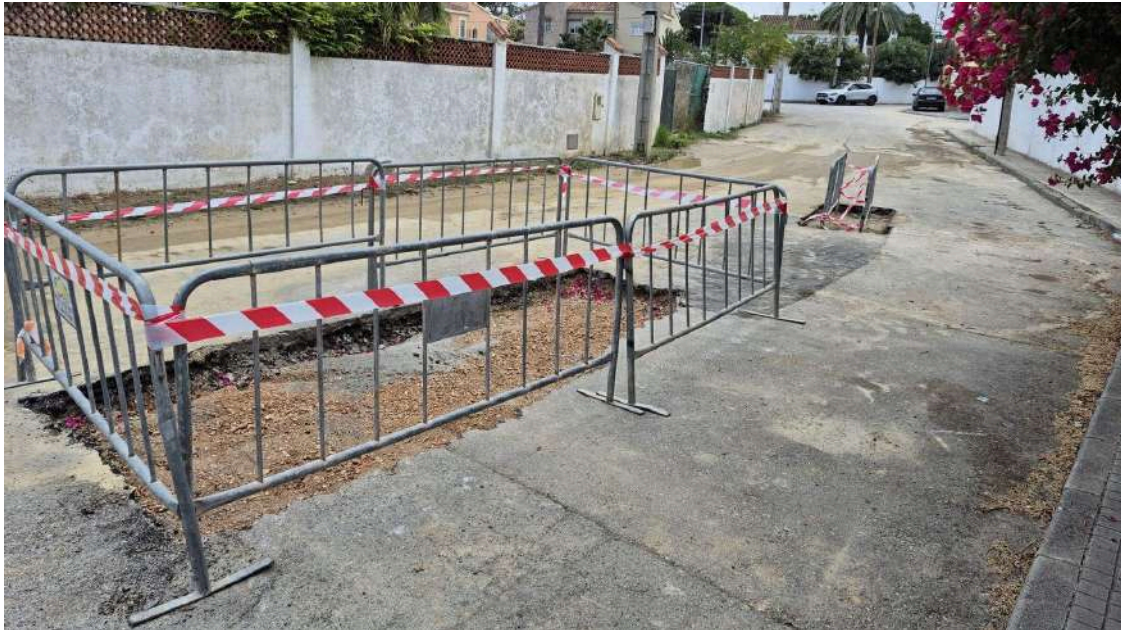
Las vallas delimitan en la calle Los Abetos varios puntos en los que se han producido roturas de la tubería.
